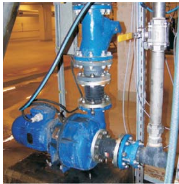
Pompa typu AB80. Osadnik anaerobowy ścieków
